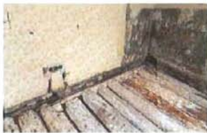
Überraschung: morsche Bauteile. [project-m]
