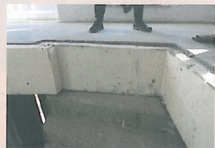
Schlechte Planung: Die Stiege „trifft“ den Estrich nicht
