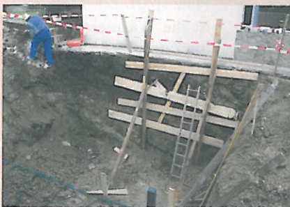
Fahrlässige Baugrubensicherung. Das Nachbarfundament droht abzurutschen
