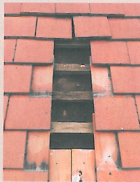
Wasserdampf hat sich unter dem Dach angesammelt. Die Folge: Die Dachlattung ist völlig morsch
